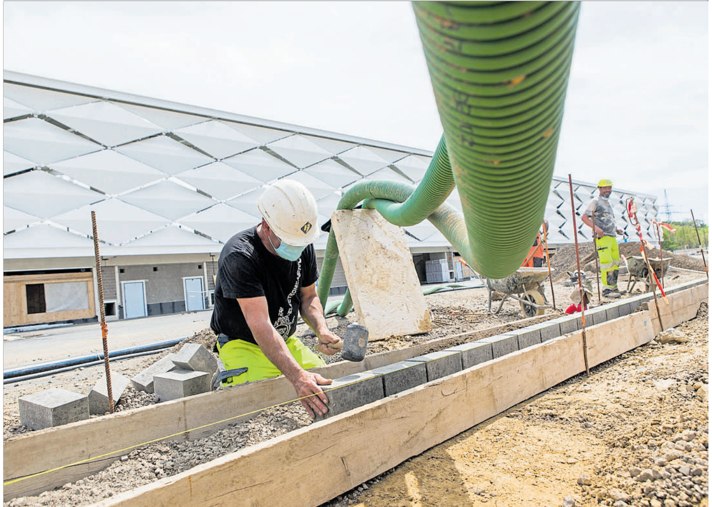
Am neuen Stadion laufen die Arbeiten wieder. Für die Unternehmen geht es jetzt darum, verlorene Zeit aufzuholen.
